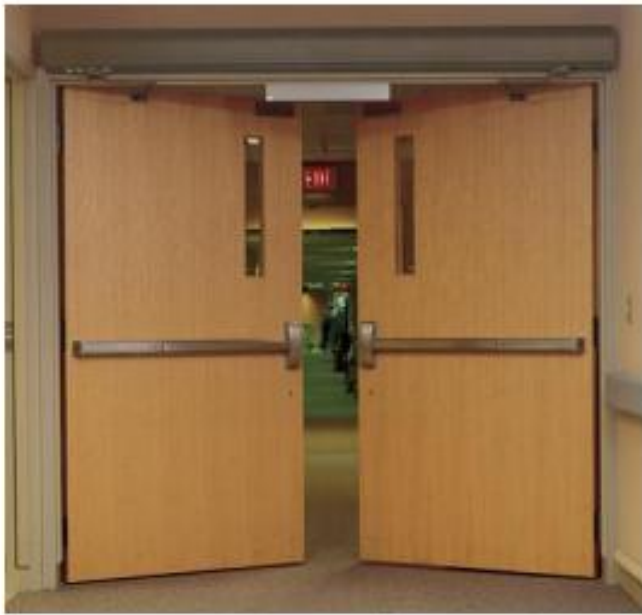
Automatic Swing Door
